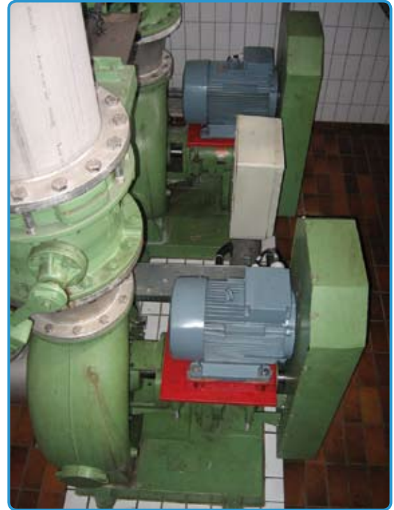
Pumpstation mit Kreiselpumpen für die Förderung von Abwasser
