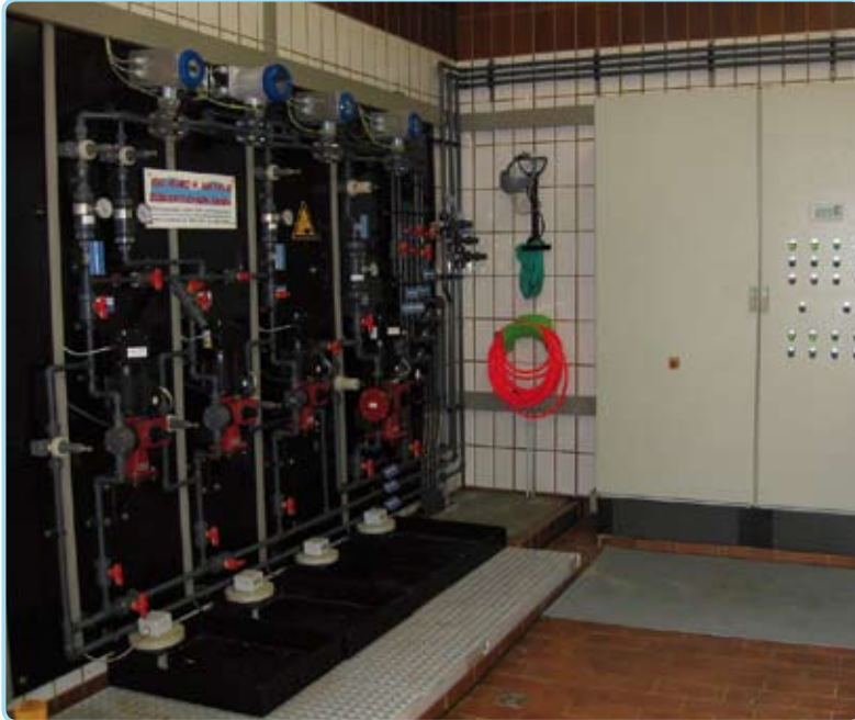
Chemische Phosphatfällung mit Dosierpumpstation
