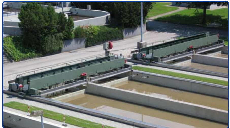
Zwei Vorklärbecken: Länge 30 m, Breite 12 m, Volumen 2 x 530 m 3
