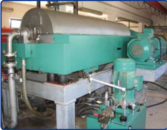
Zentrifugen zur Schlammwässerung
