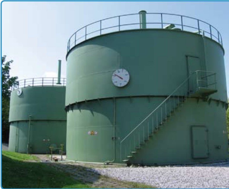
Klärgastanks, Gesamtvolumen 1400 m 3
