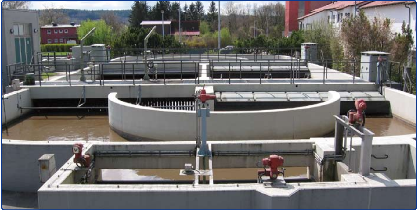
Belebungsbecken II zur Denitrifikation, Volumen 1450 m 3
