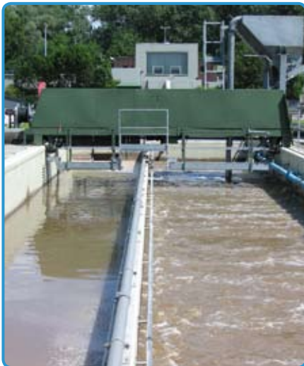
Belüfteter Sand- und Fettfang: Länge 28 m, Breite 5,5 m, Volumen 400 m 3
